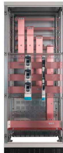
Beispiel NH-Abgangsschrank U-FL
