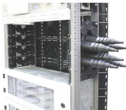
Leistenführungen und Kabelschottungen (Prinzipdarstellung hier vorbereitet zum horizontalen Einbau von NH-Leisten in den NH-Abgangsschrank U-S(I)..
