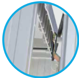
Voorzien van een doordacht ventilatiesysteem
