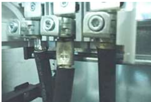
Kabelaansluiting met onvoldoende isolatie van de geleideruiteinden
