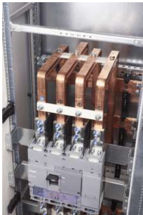
Directe aansluiting, verkopering MCCB 1000 A
