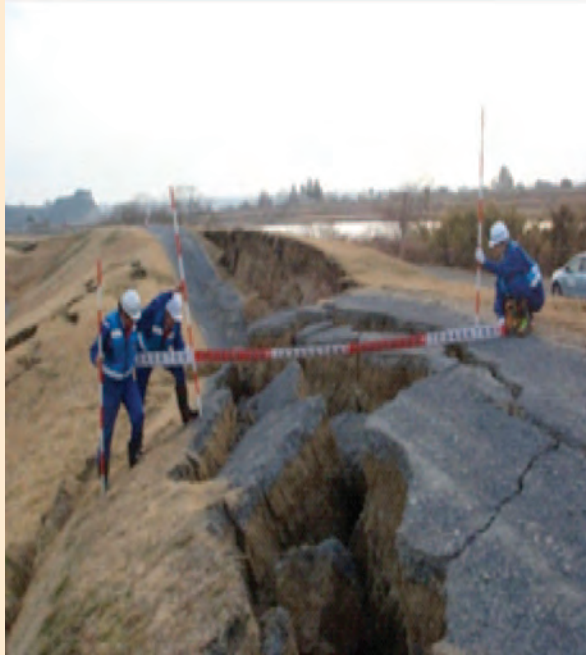
図2：鳴瀬川河川堤防の被害
