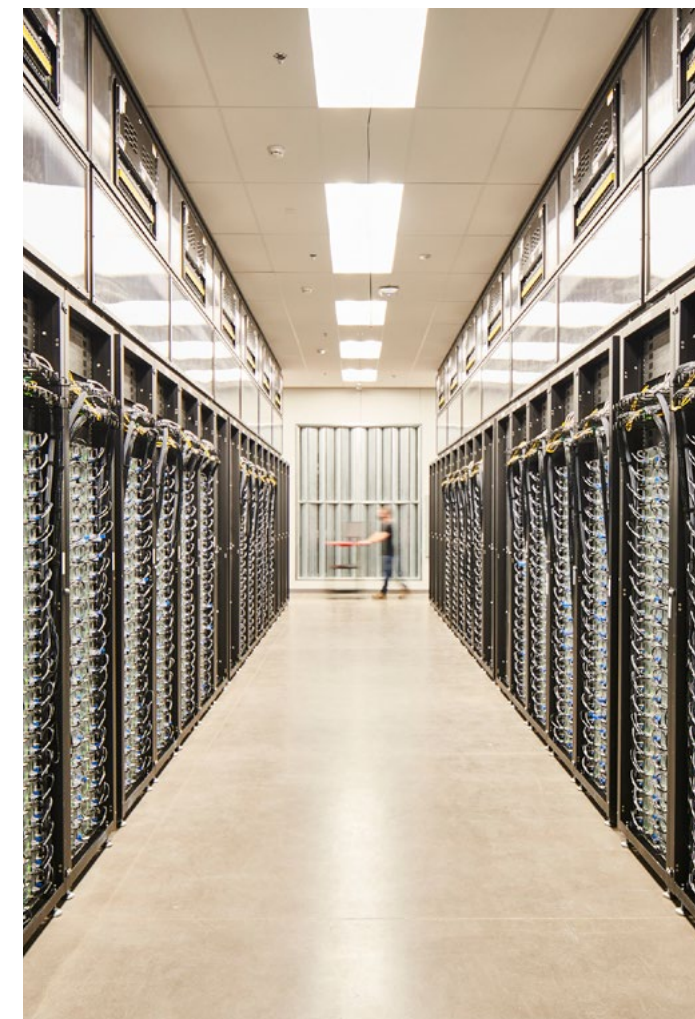
Le data center de Reno, ouvert par Apple en 2012, profite de la douceur du climat en refroidissant ses serveurs avec de l'air extérieur dès que cela est possible.
