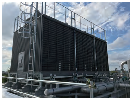
屋上に設置された冷却塔
