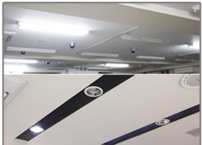
不要な照明を部分消灯
